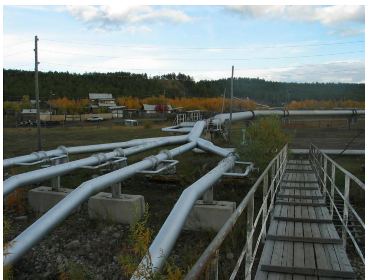
Рисунок 5.2.2 – Подводящий трубопровод магистрального водовода Лена – Туора-Кюель (Фото автора, 2004 г.)
